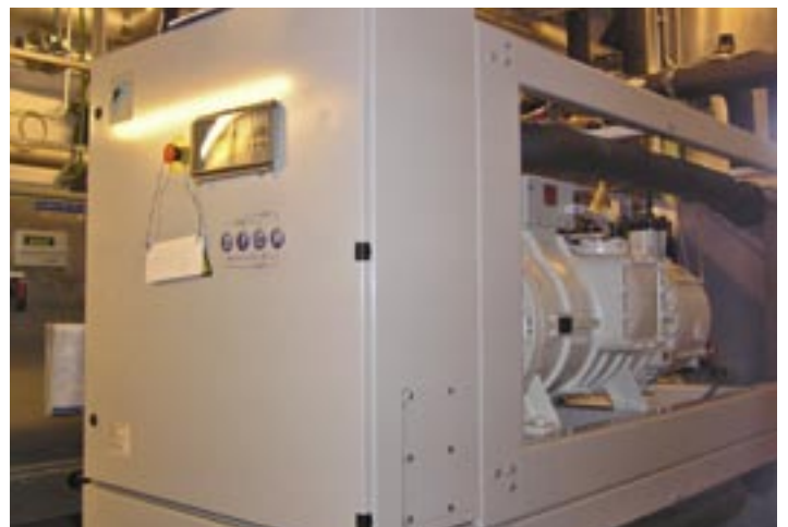
Paperiteollisuuden vaativiin tarpeisiin ei enää pienitehoiset laitteet riitä, tässä sama massiivinen vedenjäähdytyn etupuolelta.
