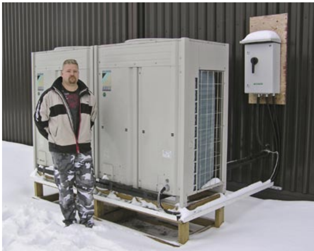
Lahden Muotoiluinstituutin katolla on kookas kahdesta ulkoyksiköstä muodostettu kokonaisuus. Kuvassa asennuksen suorittanut Chiller Oy:n alihankkija Jetpolar Oy / Klaus Katajamäki.
