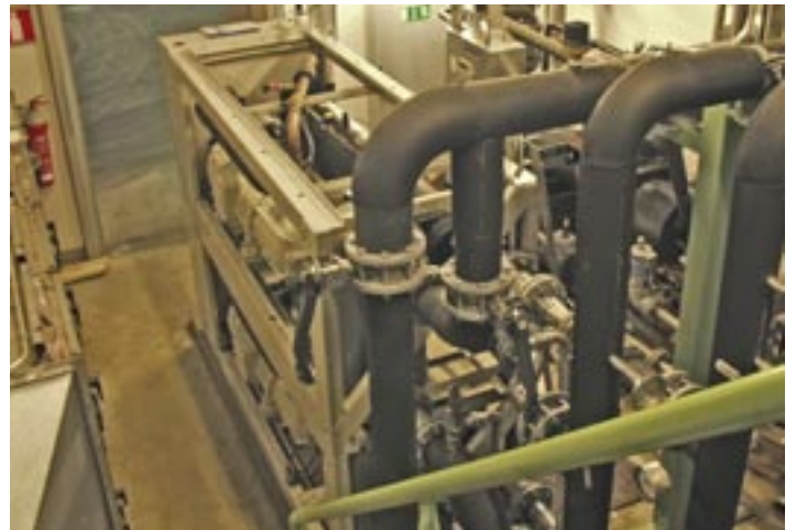
Daikin EUW-vedenjäähdytyn on jyhkeä näky putkistoinen ja venttiileinen.
